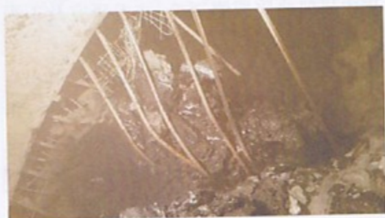
↑ 大柱山隧道进口掌子面开挖后围岩失稳
